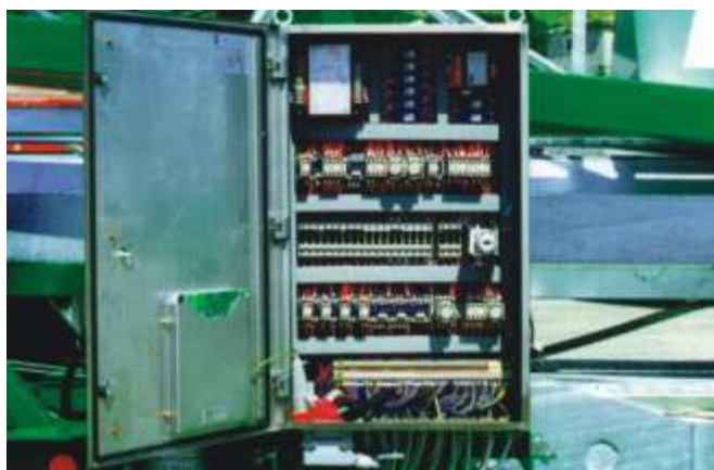
ШКАФ УПРАВЛЕНИЯ ИЗ НЕРЖАВЕЮЩЕЙ СТАЛИ
